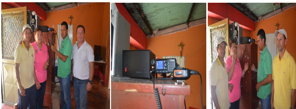
Equipo instalado en el corregimiento de Santa Teresa – Líbano Tolima
